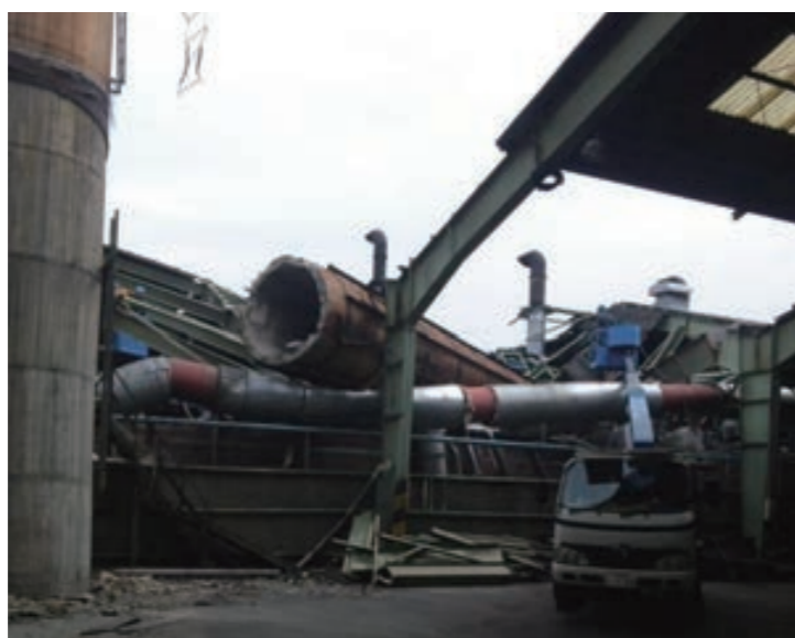
傾いた煙突は余震により完全に折損し、建屋を破損
