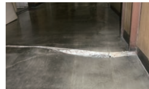
事務所の廊下：亀裂発生
